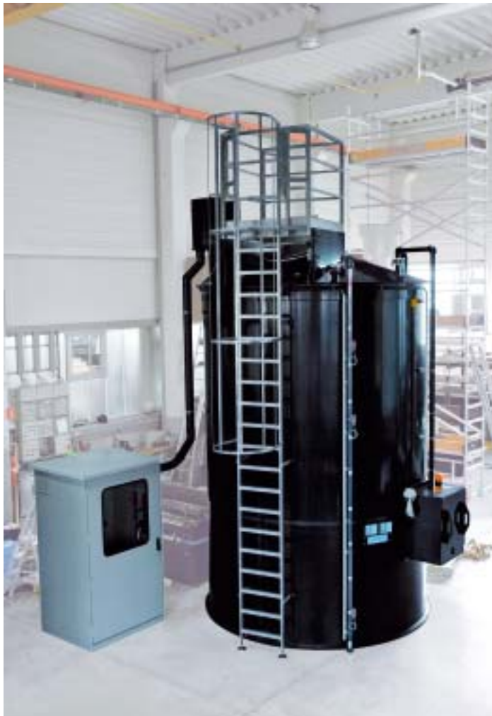
Dosierstation mit zugehörigem Lagerbehälter für die Fällungschemikalien
