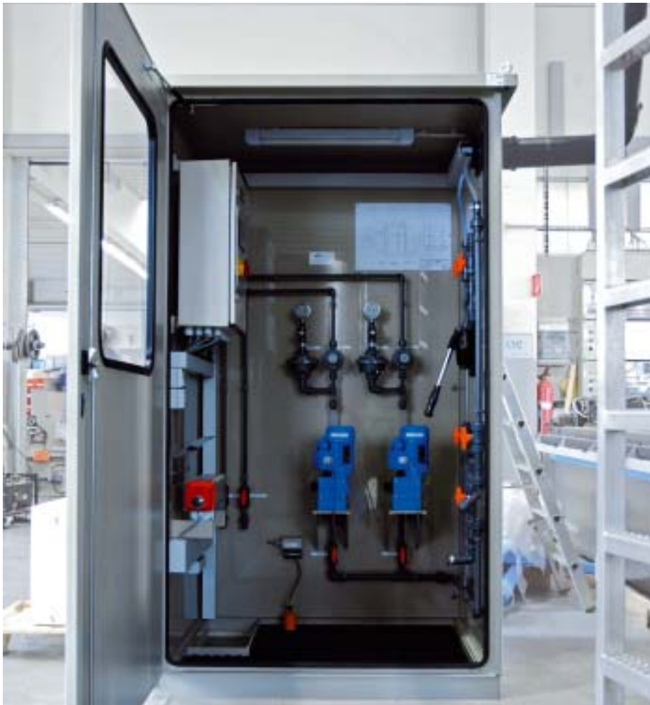
Blick ins Innere der Dosierstation: Das Kernstück des Komplettsystems ist mit zuverlässigen Kolbenmembrandosierpumpen ausgerüstet
